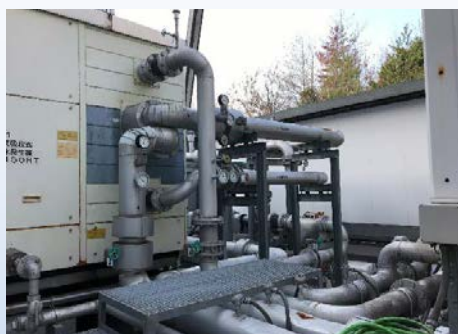
改修前：ガス炊き吸収式冷温水発生器
