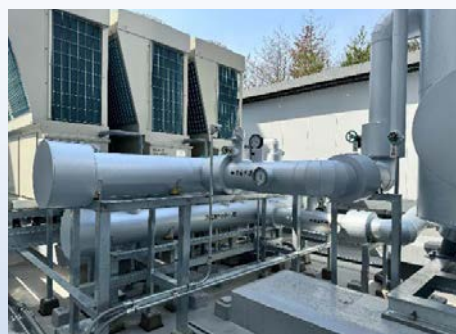
改修後：電気式モジュールチラー
