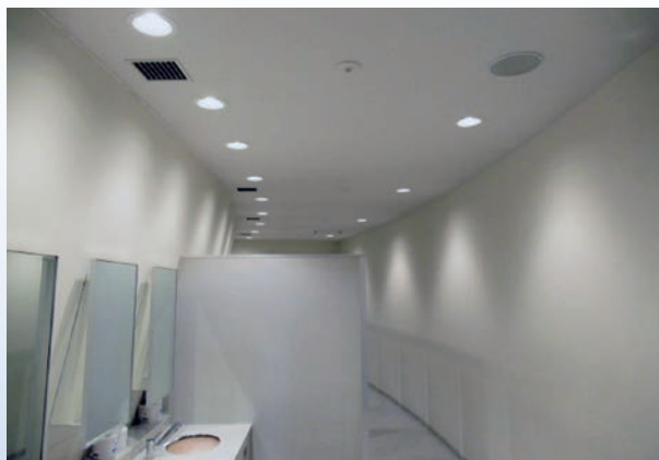
改修後：WC 照明器具（LED）
