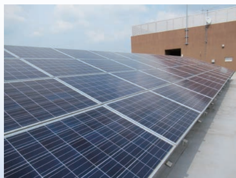
【創エネ】屋上の太陽光パネル (理学部研究棟A)
