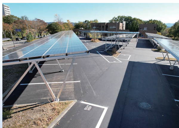
駐車場に設置した太陽光パネル（東第6駐車場）
