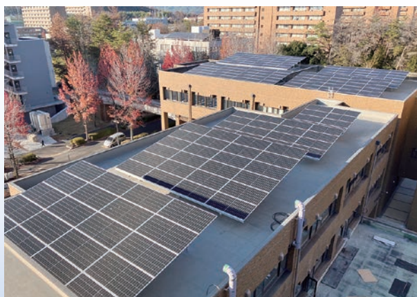
建物屋上に設置した太陽光パネル（生物生産学部講義管理棟C）
