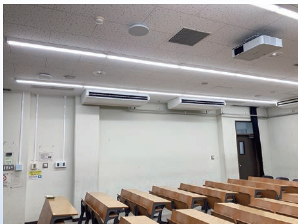
講義室内に設置された室内機（総合科学部K棟）
